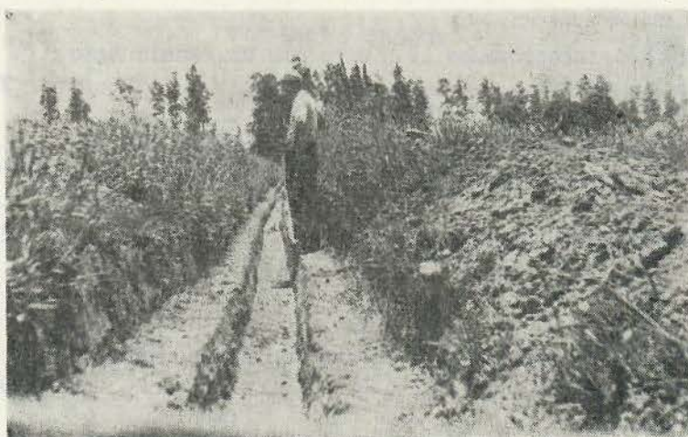
Dren tapado en construcción. (Foto Carlos Díaz V.).
